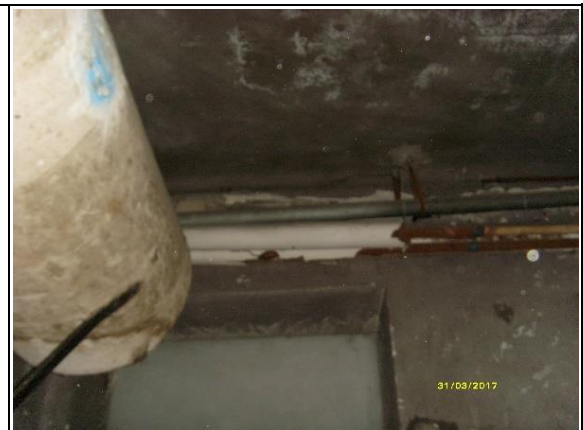
Serbatoio in cantina coibentato con cemento amianto
