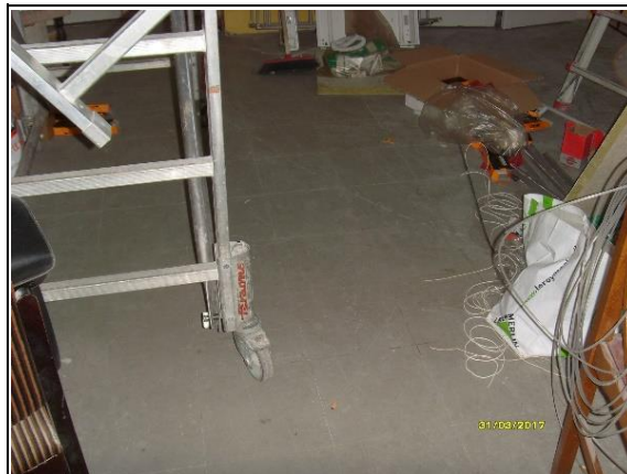
Pavimentazione in vinil-amianto in alcune aule
