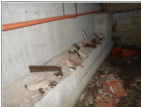
Piano interrato – Vespaio Materiali abbandonati (Rivestimento tubi)
