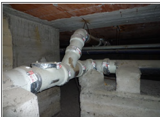
Tubazioni di scarico confinate
